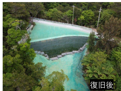
豪雨災害例：沖縄名嘉真コリメ法面崩落
