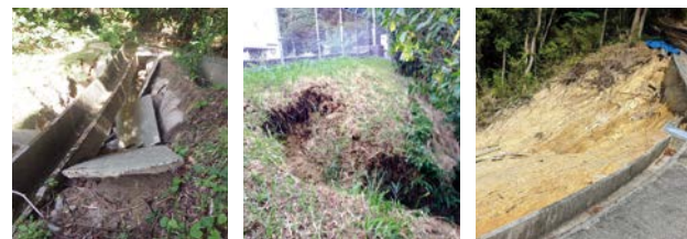
土木インフラの不具合・災害の例 左:排水構造物の破損 中:土砂の流出 右:法面崩落
