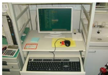
電力監視システム
