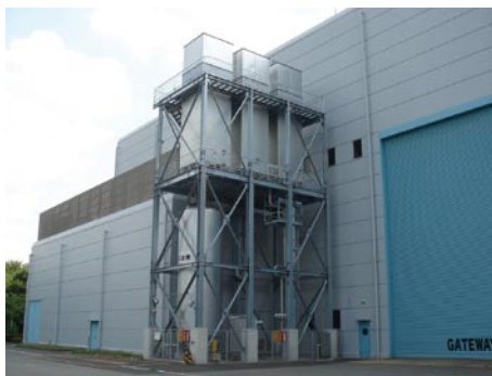
音響試験設備（液化窒素気化設備）
