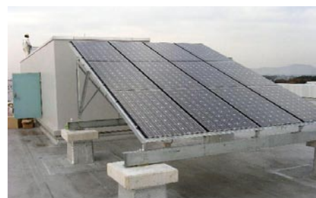
太陽光発電（音響試験棟）
