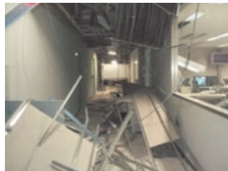
地震直後の天井脱落
