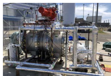
液体水素用大型バルブの試験の様子
