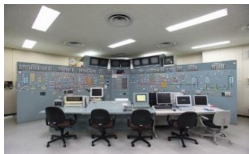
計測室 モニタ、制御機器 収録機器増設
